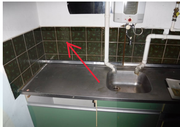
Asbest tegellijm keuken
