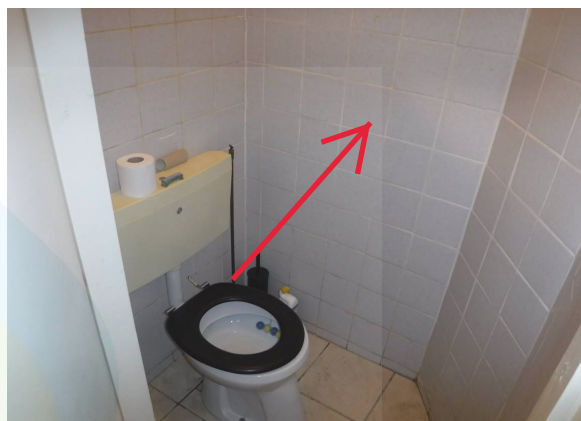
asbest tegellijm toilet en keuken
