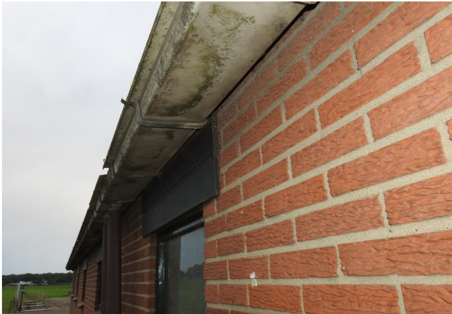
Dakgootbekisting en kozijnen zijn onderzocht op ruimtes, kieren en spleten waar mogelijk Huismussen en/of andere holtebewonende dieren kunnen zitten. (M. van Leeuwen, 23 juni 2021)
