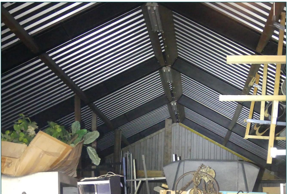
Figuur 4 De binnenzijde van schuur 1 is vol gezet met verschillende materialen en beschikt over een damwandplaten dakbeschot.
