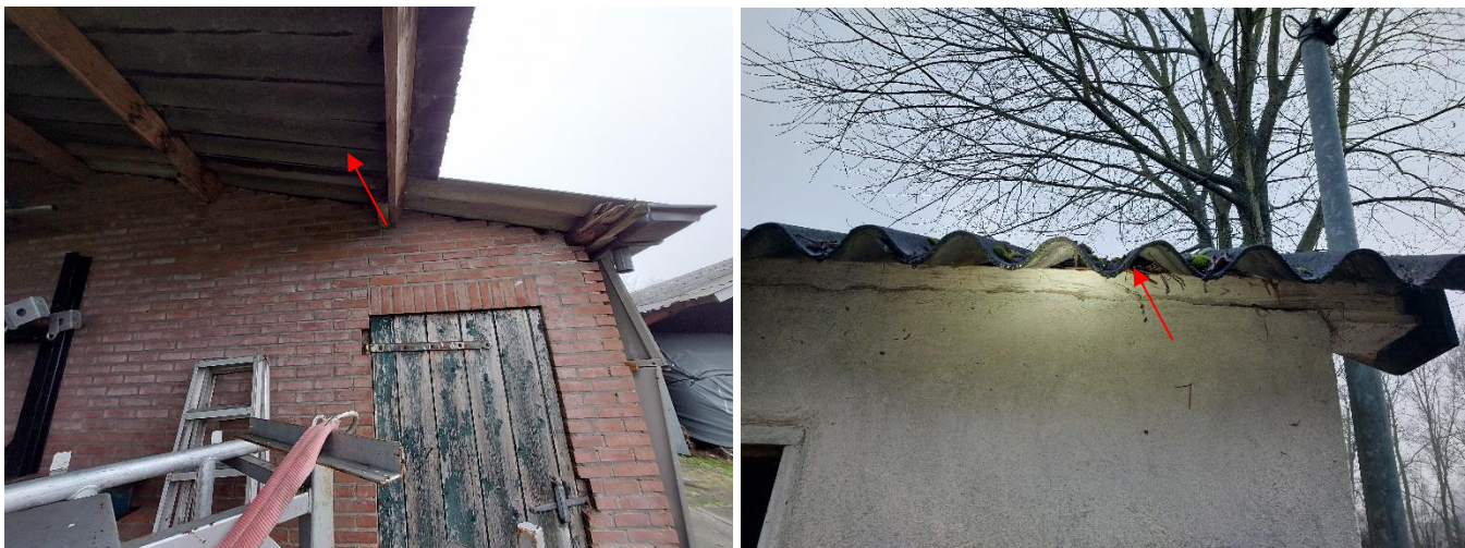
Figuur 32. Aanwezigheid van asbest binnen het projectgebied. Foto links: Schuur met asbest op het perceel van Nederwoudseweg 66/68 (zie rode pijl). Foto rechts: Schuur met asbest op het perceel van Nederwoudseweg 86 (zie rode pijl).
