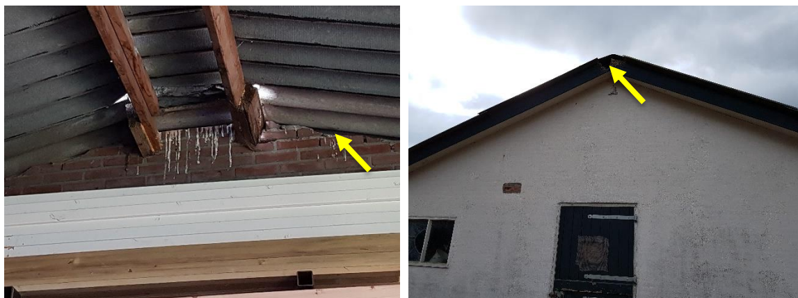
Figuur 7. Openingen aan de achterzijde van schuur 2 (links) en een gat aan de nokrand van gebouw 8 (rechts) bieden toegang tot de loze ruimte onder het dak en spouwruidtes.
