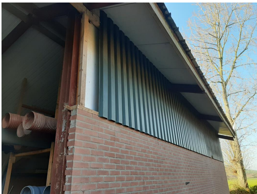
Figuur 4 De damwandplaten van schuur G zijn aan de onder- en zijkant open, waardoor hier geen beschutte ruimte aanwezig is.
