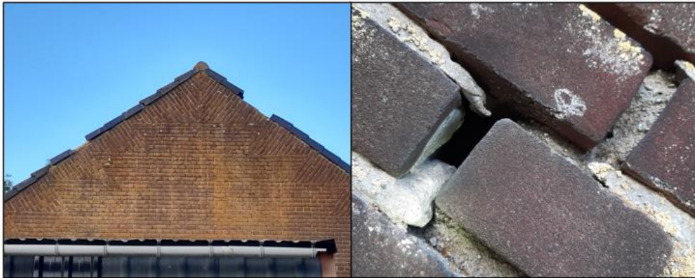
Figuur 4 Missende kantpannen op het dak en missende specie in de muur met luchtsponw van gebouw B.
