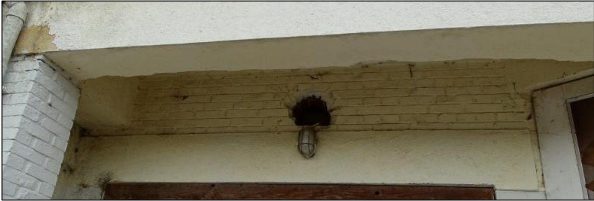
Figuur 5.22. Gat in de muur aan de Oude Schans 22, geschikt als toegangsmogelijkheid voor vleermuizen.
