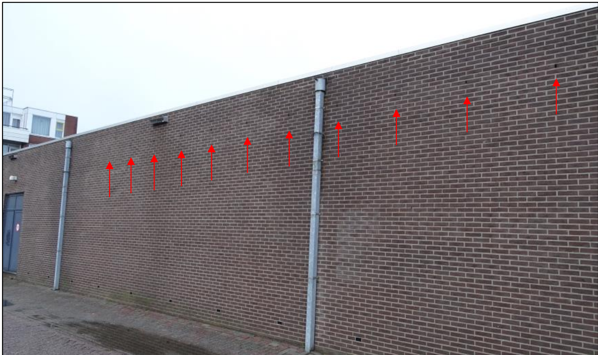
Figuur 5.17. Open stootvoegen in het winkelpand van de Albert Heijn.
