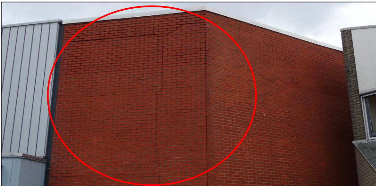
Figuur 5.27. Grote scheur in de muur van de Action, voldoende groot en toegankelijk voor vleermuizen.
