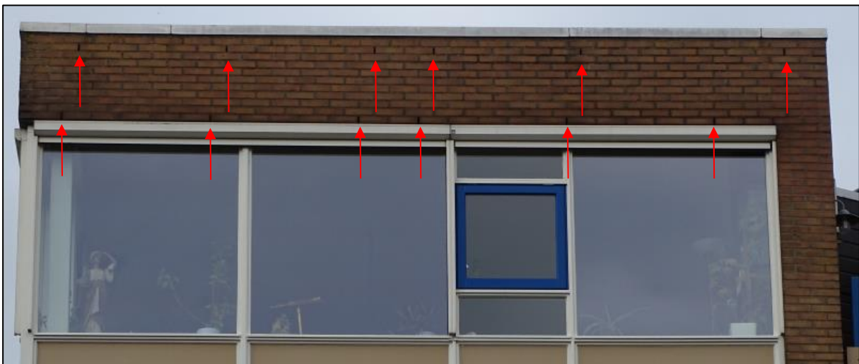
Figuur 5.23. Openstootvoegen onder de dakrand van de bovenste woning.
