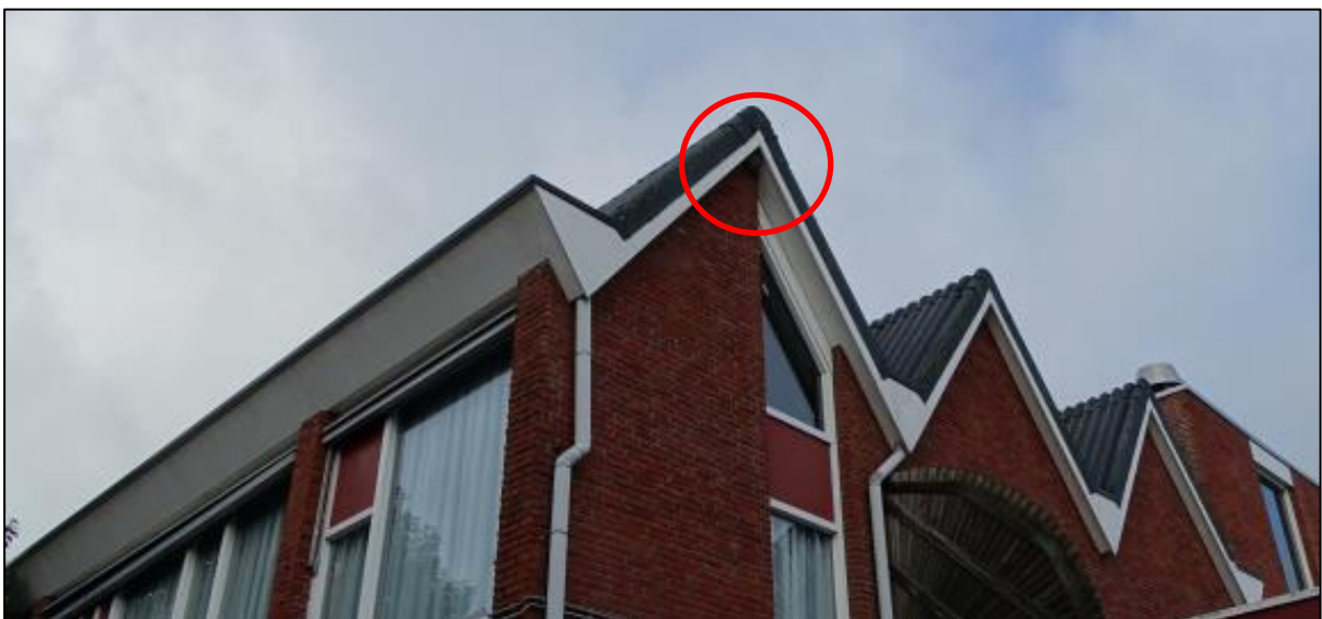
Figuur 5.12. Huiszwaluwnest in de nok van het dak.
