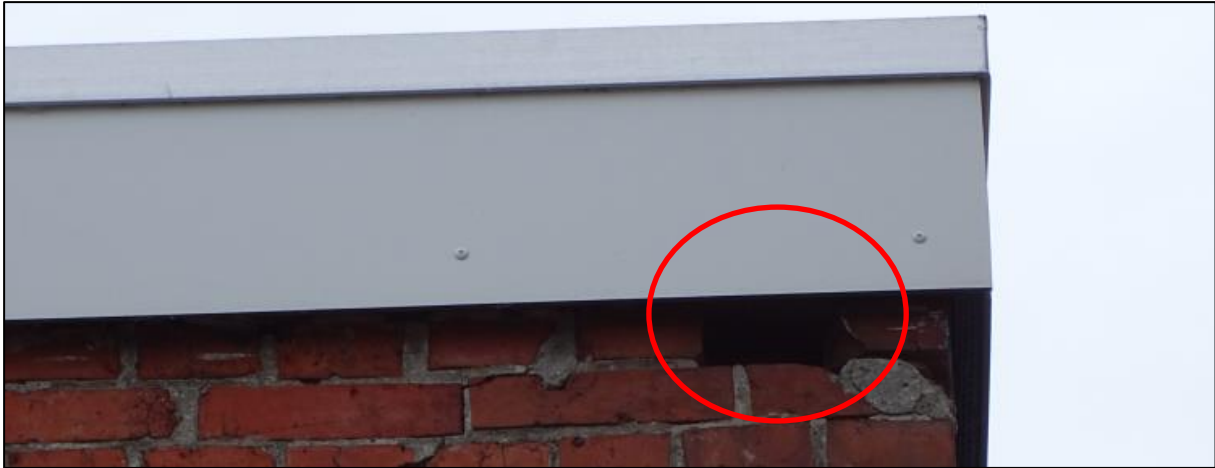
Figuur 5.26. Gat in muur onder boeirand aan achterzijde Eemskanaal N.Z. 5.
