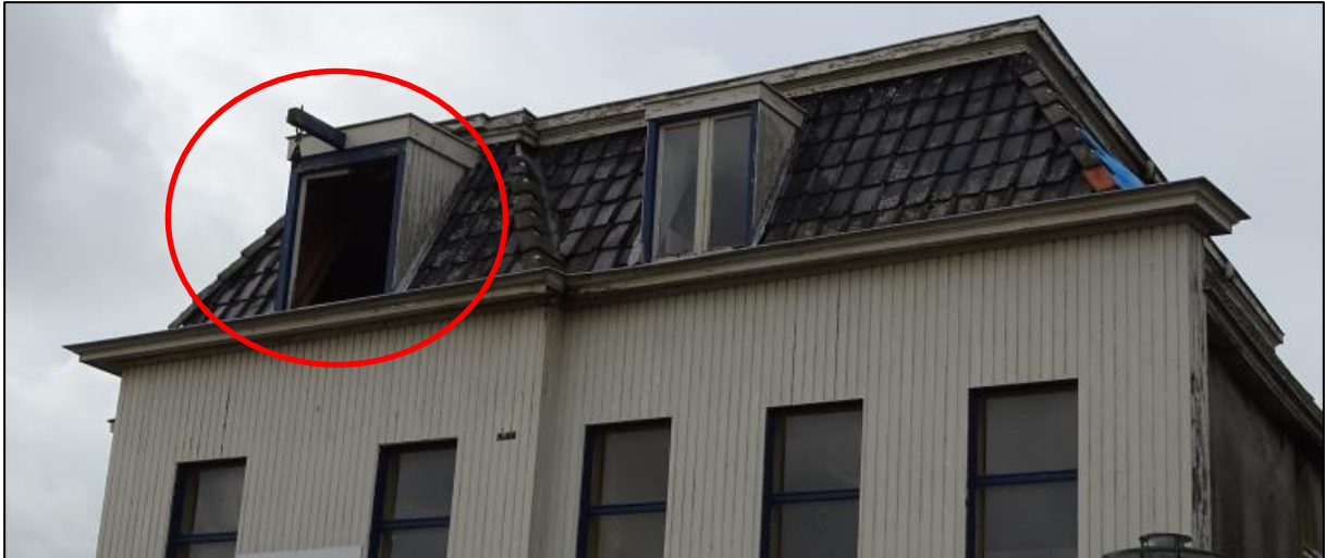
Figuur 5.24. Een missend raam aan de Nieuweweg 5, vleermuizen kunnen hierdoor naar binnen vliegen.
