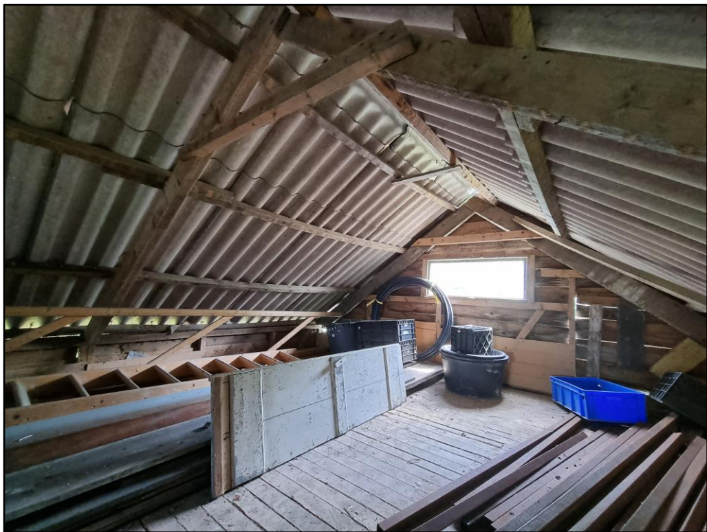
Figuur 4 De zolder van de schuur met zichtbaar ontbrekend dakbeschoot.
