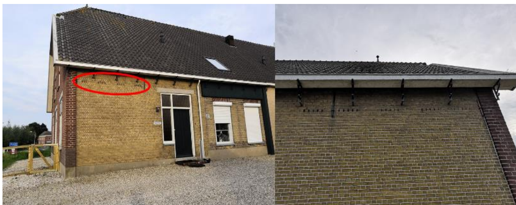
Figuur 4 In de (voorzijde van de) woning zijn open stootvoegen aanwezig welke leiden tot een ruimte achter de muur en mogelijk door vleermuizen kunnen worden gebruikt als rust- en/of verblijfplaats.
