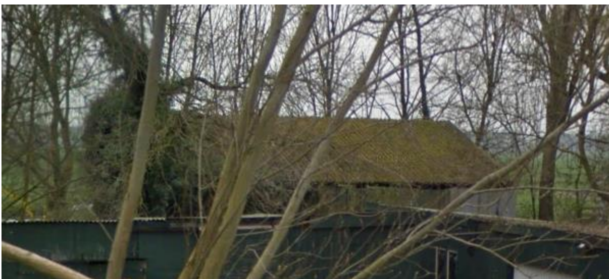
Afbeelding 9: Verouderd bijgebouw achter de wetering
