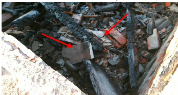
Foto 13. Asbesthoudende restanten plaat (bron 1)
