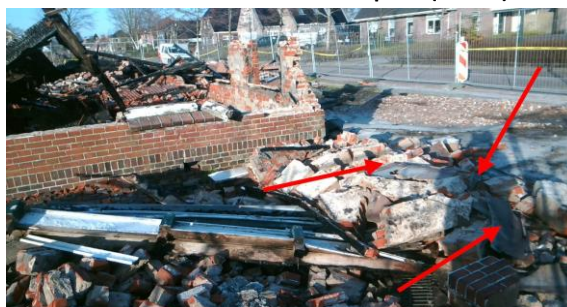
Foto 16. Asbesthoudende restanten plaat (bron 1)
