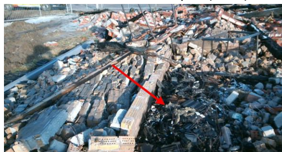
Foto 6. Asbesthoudende restanten plaat (bron 1)
