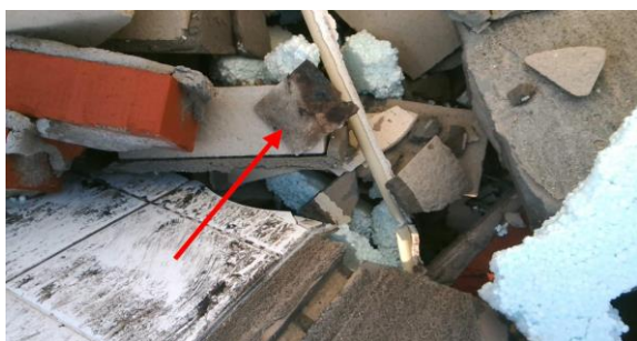
Foto 17. Asbesthoudende restanten plaat (bron 1)
