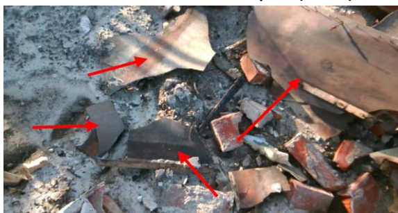
Foto 15. Asbesthoudende restanten plaat (bron 1)
