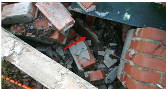
Foto 9. Asbesthoudende restanten plaat (bron 1)
