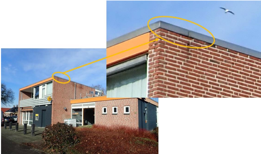
Foto 7 Het hogere deel van het gebouw heeft ook kieren tussen de aluminium daklijst en gevel waar vleermuizen de spouwmuur in kunnen kruipen.
