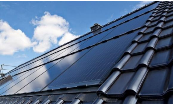
Zonnepanelen in grotere aaneengesloten vlakken
