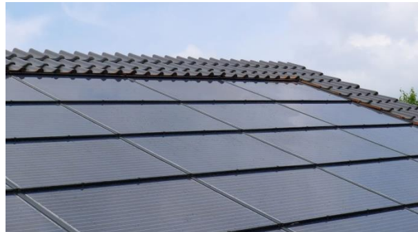
Zonnepanelen geïntegreerd in dakvlak
