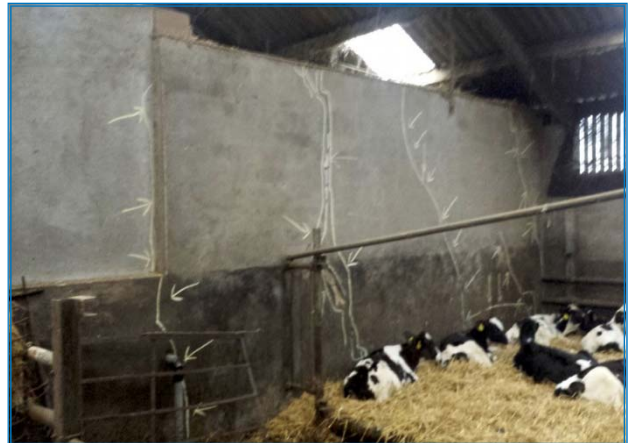
Figuur 1-1 Foto van de schade aan de bedrijfsgebouwen
