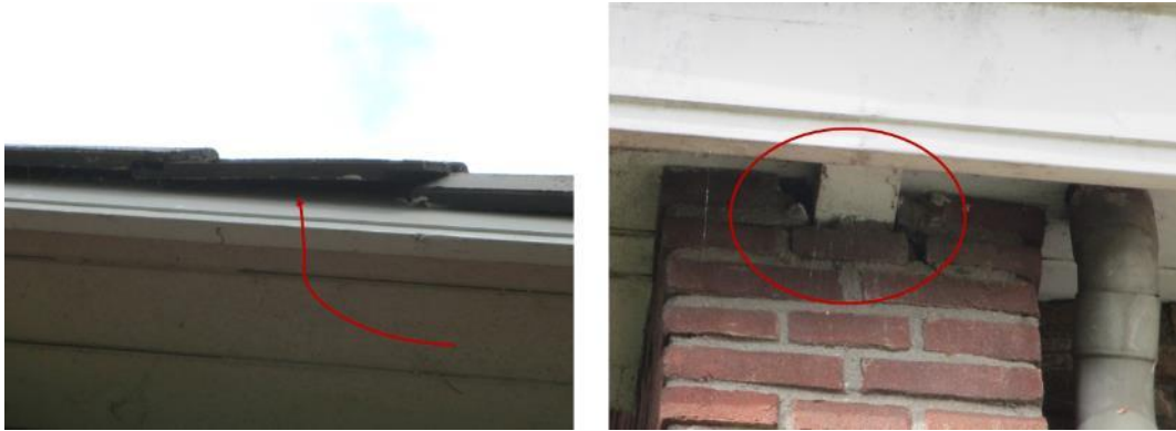
Figuur 10 Voorbeelden van potentiële inliggingen voor vleermuizen of gierzwaluwen in de woningen aan de Wilhelminastraat 34 & Prins Bernhardlaan 6-8 te Puttershoek. Tevens zijn de onderste rij dakpannen toegankelijk voor huismussen.
