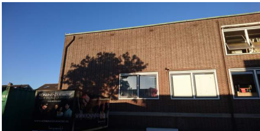
Voor vleermuizen en gierzwaluw potentiële verblijfplaatsen achter dakrand en in ventilatieroosters in het plangebied . Foto: Ecoresult B.V.
