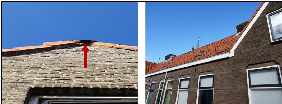
Figuur 2.5 Links: mogelijke openingen die gebruikt kunnen worden door vleermuizen. Rechts: de dakruimte is toegankelijk voor huismussen.
