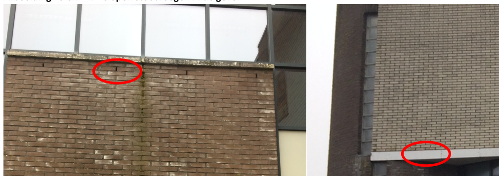
Afbeelding 13 en 14. De open stootvoegen in de gevel
