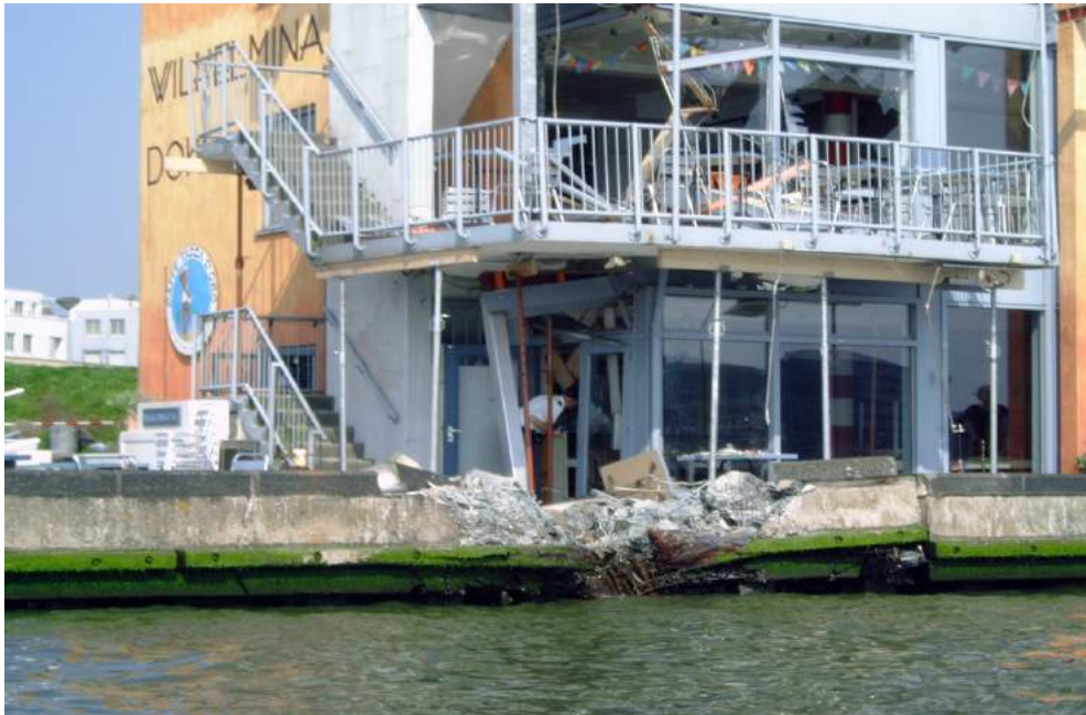
Afbeelding 10 Schade Restaurant Wilhelminadok (Bron Rijkswaterstaat)
