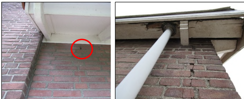
Figuur 4.3: Een spouwmuurgat en openingen onder de dakgoot die als verblijfplaats voor vleermuizen kunnen functioneren.
