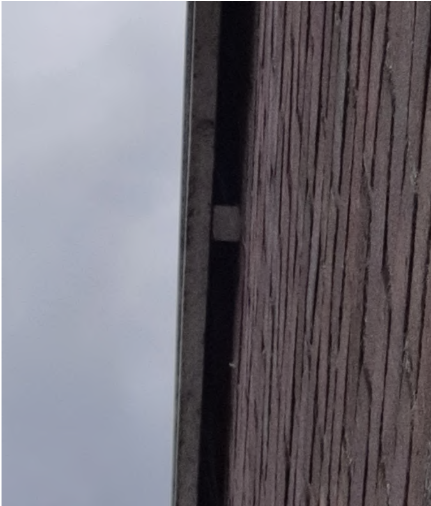
Afbeelding 11: Voor vleermuizen geschikte ruimte achter een boeiboord in het plangebied. Foto: M.M. Bouwmeester | Ecoresult B.V.
