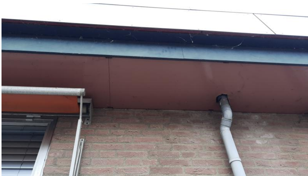
Detail van het dakoverstek van het kantoorpand binnen het plangebied. Langs de gevel en bij de regenpijp bevinden zich voor vleermuizen geschikte openingen. Foto: FM.M. Bouwmeester | Ecoresult B.V.
