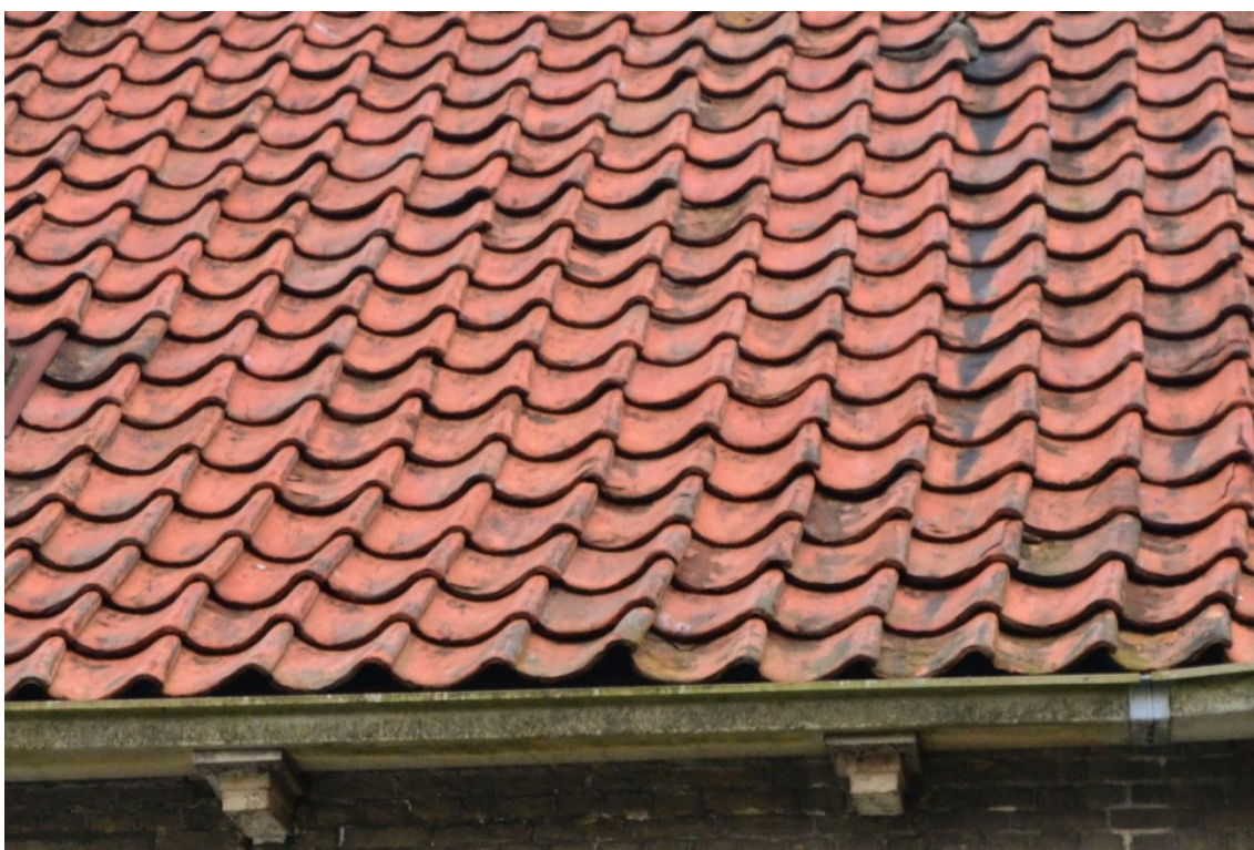
Figuur 6. Losse dakpannen en grote openingen aan de onderkant bieden mogelijkheid voor huismussen en vleermuizen.
