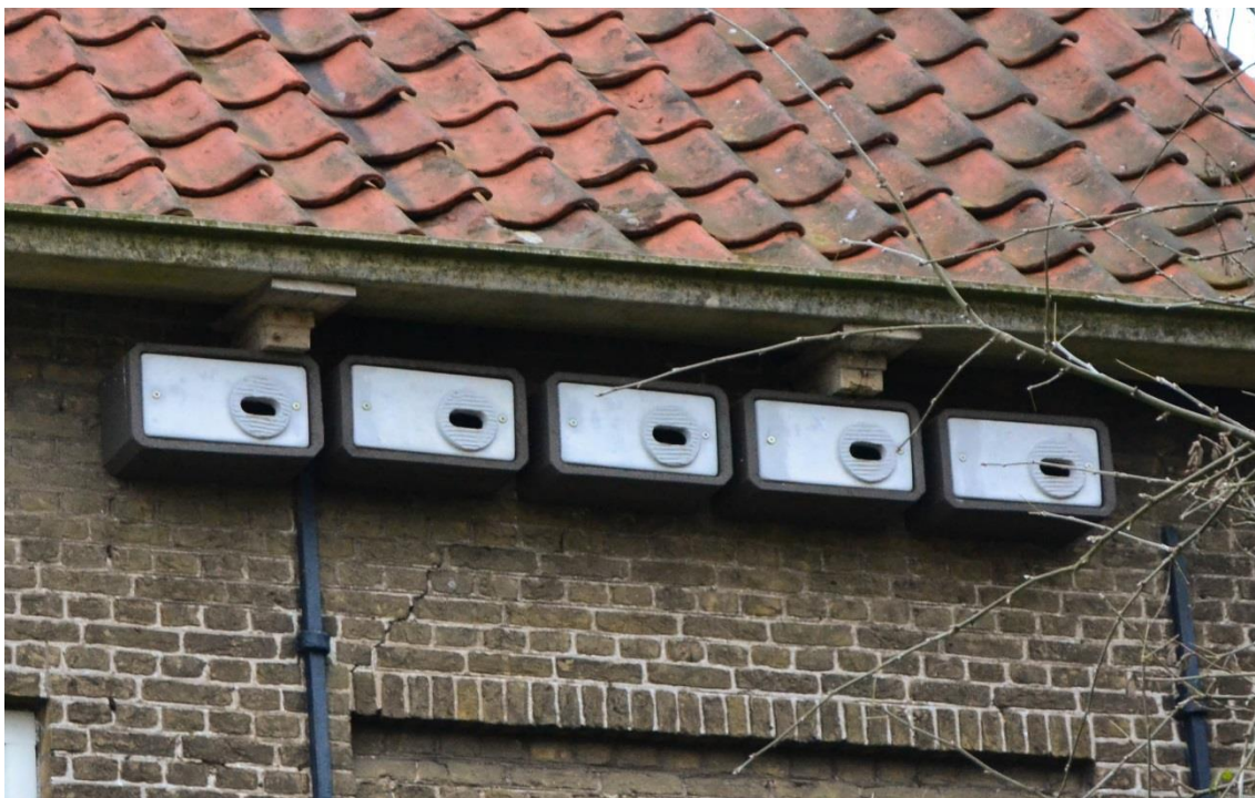
Figuur 5. Huismuskasten aan de achterkant van de woning.
