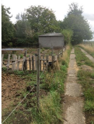
Figuur 7: Asbestverdachte dakbedekking
