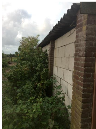
Figuur 8: Asbestverdachte dakbedekking
