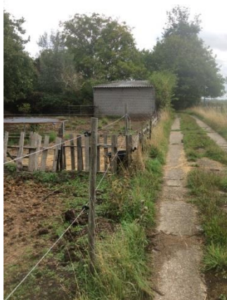
Figuur 7: Asbestverdachte dakbedekking
