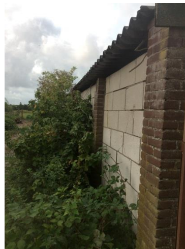
Figuur 8: Asbestverdachte dakbedekking
