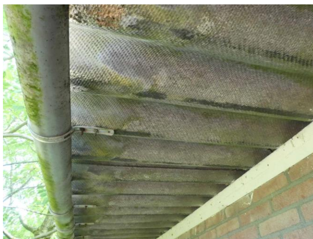
Figuur 13: Dakplaten op de schuur
