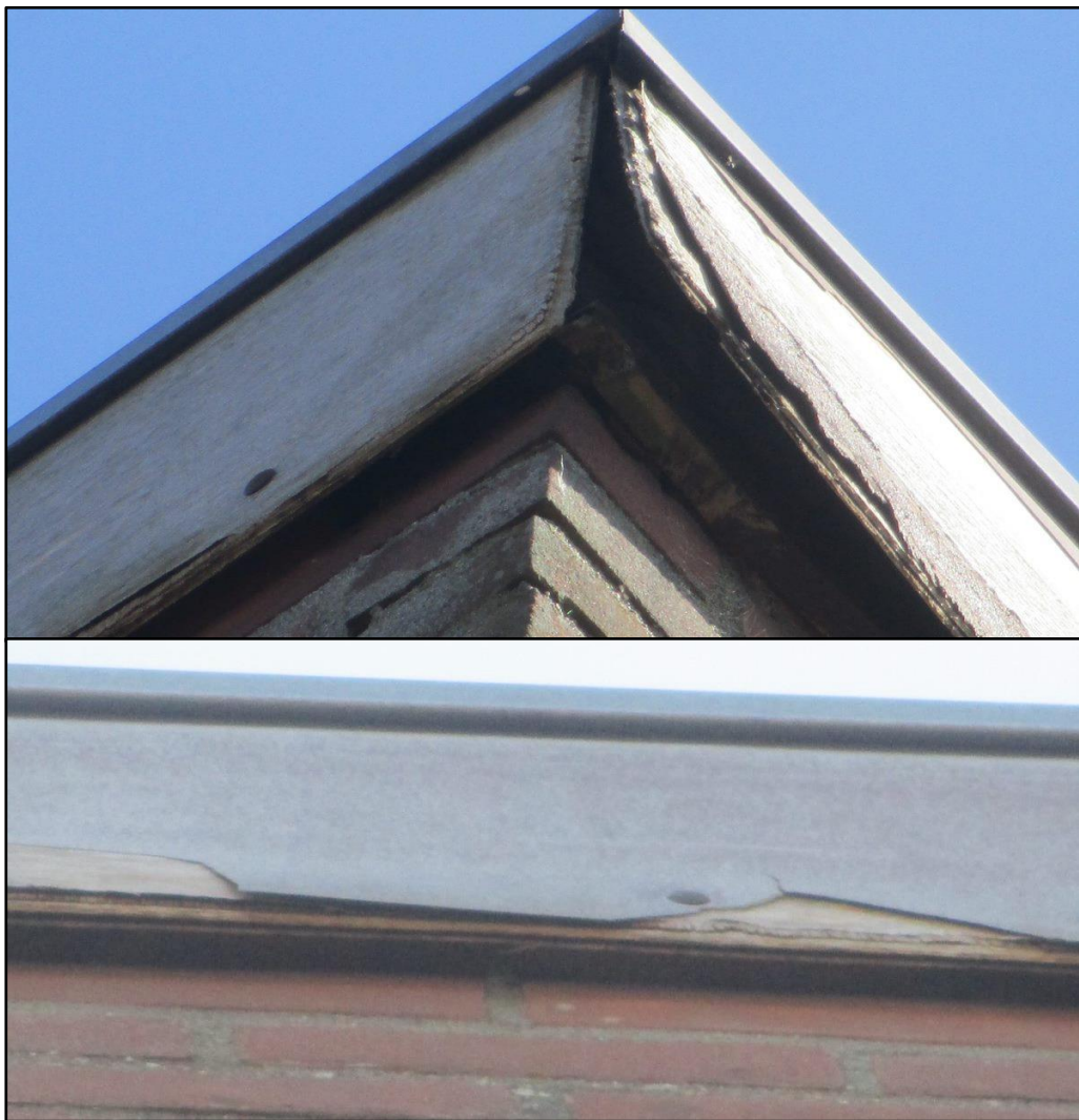
Figuur 4 Onder het boeibord van de voormalige bedrijfsloods is een kier aanwezig waar vleermuizen onder kunnen kruipen en via waar ze mogelijk ook toegang krijgen tot de spouw.
