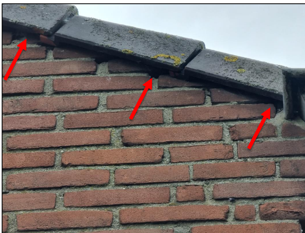
Figuur 5 De dakrand van de woning met zichtbaar kierende kantpannen en plaatsen waar specie niet aansluit aan de dakrand. Hierdoor kunnen vleermuizen mogelijk verblijfplaatsen vinden in de dakruimte.
