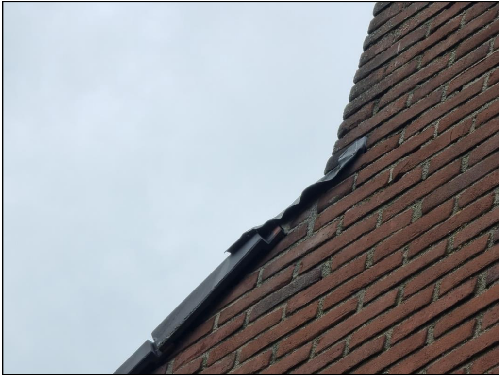
Figuur 3 De kopgevels van de woning bevat kierende kantpannen en zichtbaar kierende loodflappen waar gierzwaluwen en vleermuizen mogelijk geschikte nest- of verblijfplaatsen kunnen vinden.
