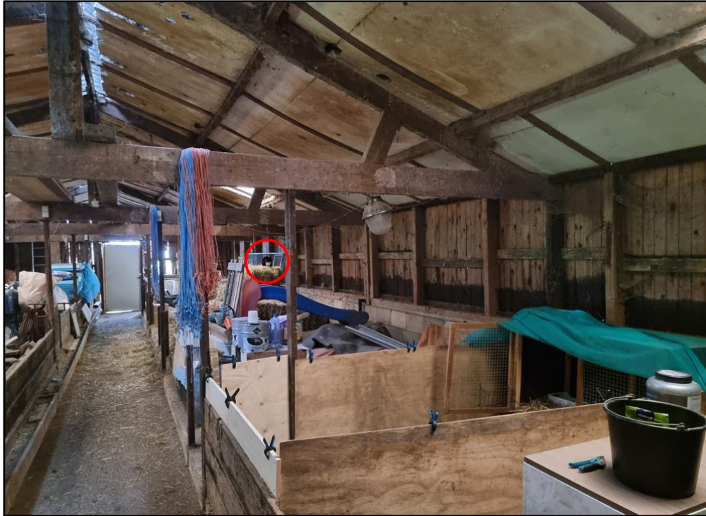
Figuur 6 Zichtbaar vertering van de isolatieplaten op het dak van de geitenstal. Te tijden van het veldbezoek was een boerderijkat aanwezig op de planlocatie (rood omcirkeld)
