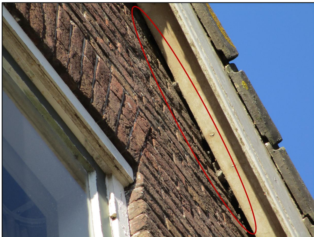
Figuur 1.4 Potentiele toegang naar achterliggende ruimte, welke kunnen dienen als vaste rust- en/of verblijfplaats voor vleermuizen.
