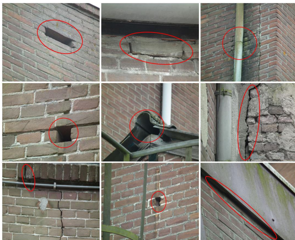
Figuur 3 In de bebouwing van de planlocatie zijn verschillende openingen die mogelijk geschikt zijn als vaste- rust en/of verblijfplaats voor vleermuizen (rood omcirkeld).
