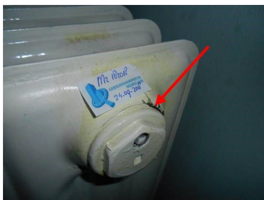
Foto 9 | pakkingen in radiatoren
