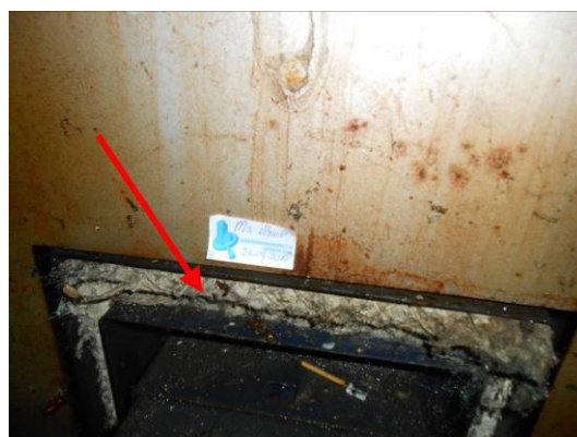
Foto 14 | gevelkachel met koord rond rookgasafvoer
