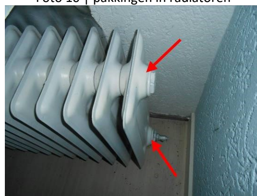
Foto 12 | pakkingen in radiatoren
