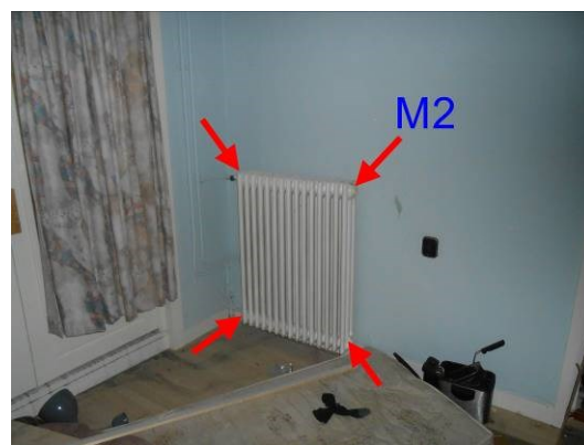
Foto 10 | pakkingen in radiatoren
