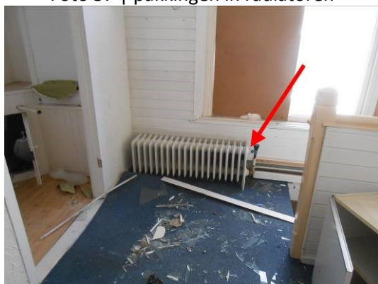
Foto 59 | pakkingen in radiatoren
