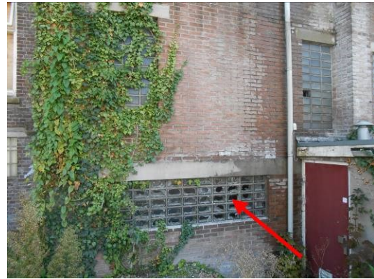
Foto 40 | bitumen tussen glazen bouwstenen achtergevel nr.48
