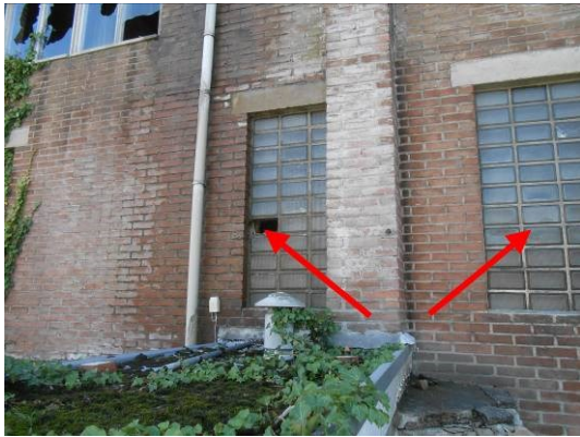
Foto 39 | bitumen tussen glazen bouwstenen achtergevel nr.48
