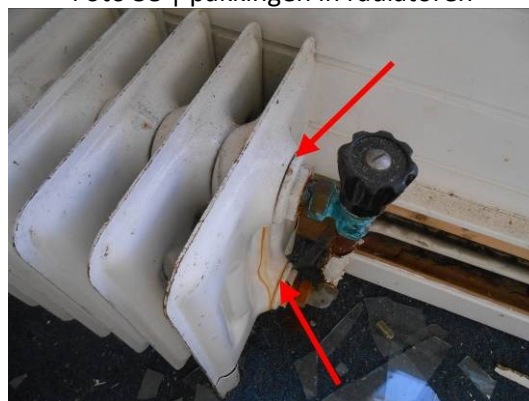
Foto 60 | pakkingen in radiatoren
