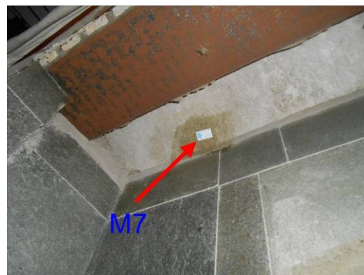
Foto 55 | plaatmateriaal in schouw
