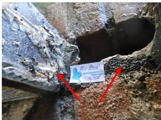
Foto 35 | bitumen tussen glazen bouwstenen achtergevel nr.48
