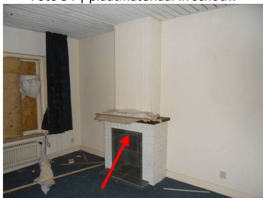
Foto 56 | plaatmateriaal in schouw
