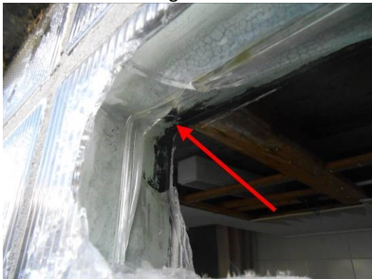
Foto 41 | bitumen tussen glazen bouwstenen achtergevel nr.48
