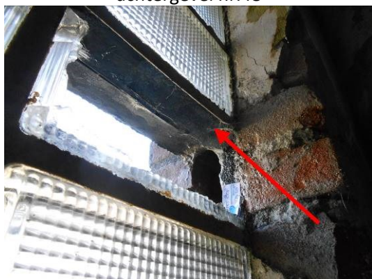
Foto 37 | bitumen tussen glazen bouwstenen achtergevel nr.48
