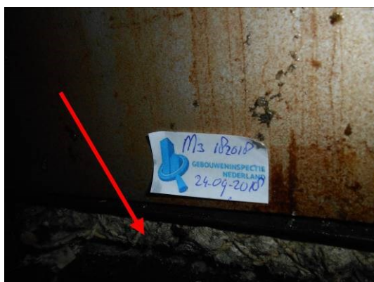
Foto 13 | gevelkachel met koord rond rookgasafvoer
