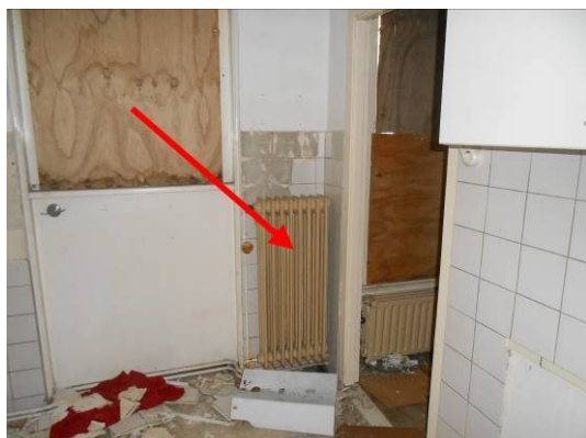
Foto 57 | pakkingen in radiatoren
