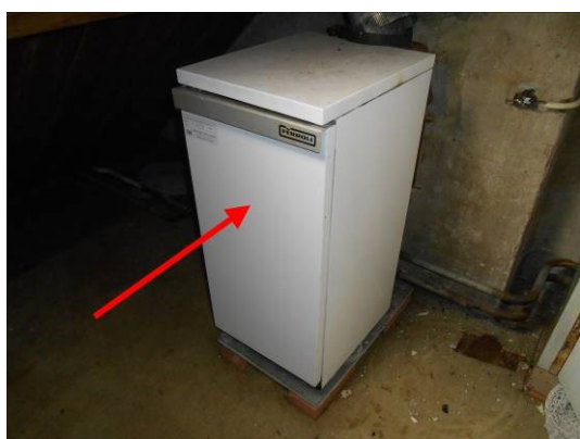
Foto 61 | Ferroli FGZ 18 cv ketel, 3 leden, bouwjaar 1973
