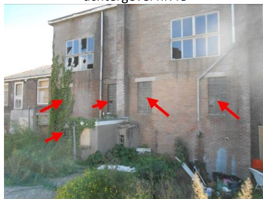
Foto 38 | bitumen tussen glazen bouwstenen achtergevel nr.48
