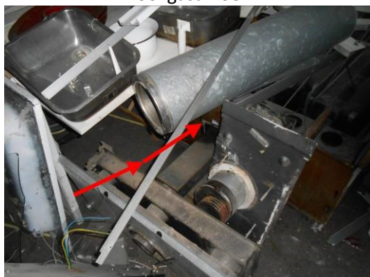
Foto 15 | gevelkachel met koord rond rookgasafvoer
