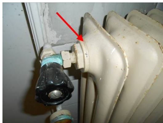
Foto 58 | pakkingen in radiatoren
