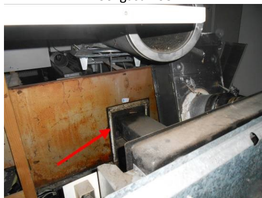
Foto 16 | gevelkachel met koord rond rookgasafvoer
