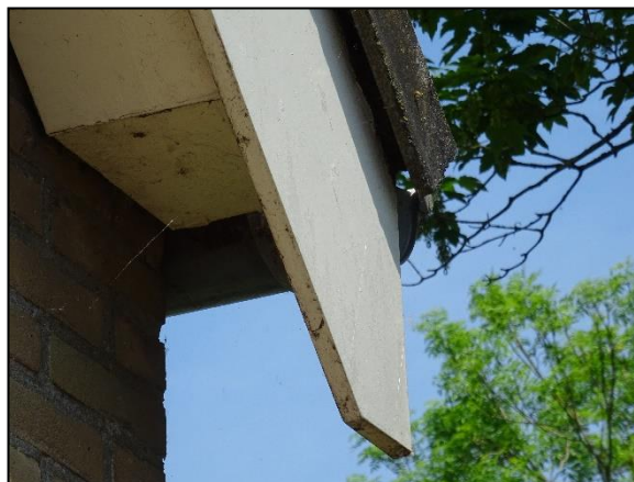
Figuur 17. Opening onder overhangende dakpan welke bereikbaar is via de dakgoot voor huismussen.
