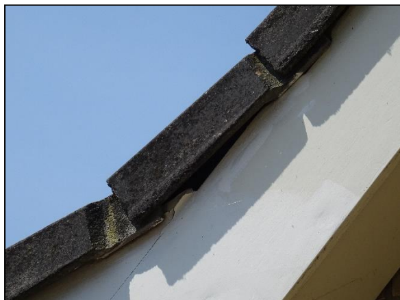
Figuur 16. Opening onder overhangende dakpan welke geschikt is als nestlocatie voor huismus of als verblijfplaats voor vleermuizen.
