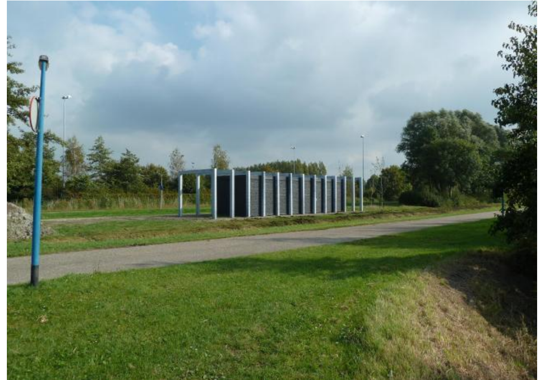
Voorbeeld: verdeelstation Enexis (Kardinge Groningen)
