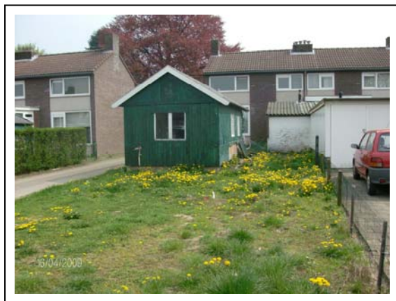
Foto 1: Achterzijde woningen Kloosterstraat 29-31, asbestverdachte platen op schuurtje
