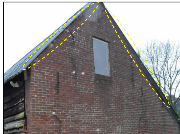
Figuur 10. Potentiële broedgelegenheid voor huiswassen, tussen de muur en het golfplaten dak.
