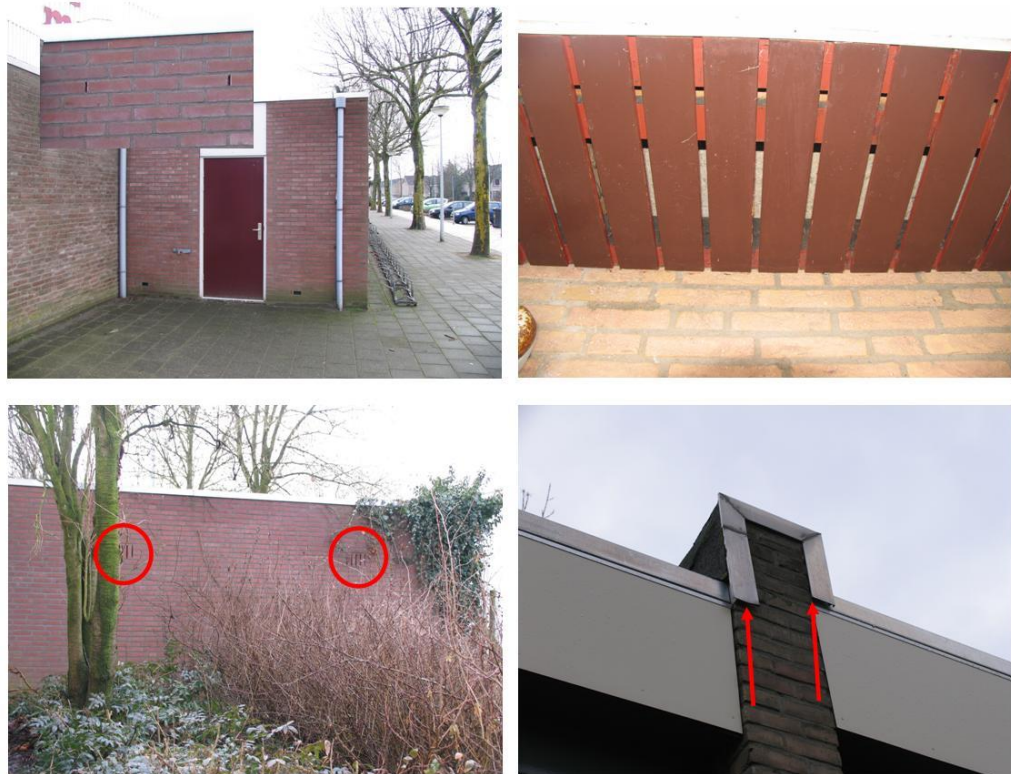
Afbeelding 3: mogelijke toegangsopeningen tot geschikte schuilplaatsen voor vleermuizen. Linkerzijde: spouwmuren met open stootvoegen of ventilatievoegen. Rechtsboven: overkapping aan de onderzijde op veel plaatsen zeer toegankelijk. Rechtsonder: kieren die mogelijk toegang bieden tot spouwruintes. (Foto's: SAB 2010).
