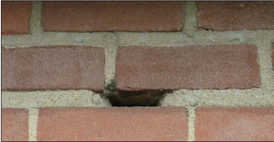
Figuur: drie open stootvoegen zijn aanwezig in één van de stallen waardoor vleermuizen de spouwmuur in kunnen en verblijven kunnen hebben.
