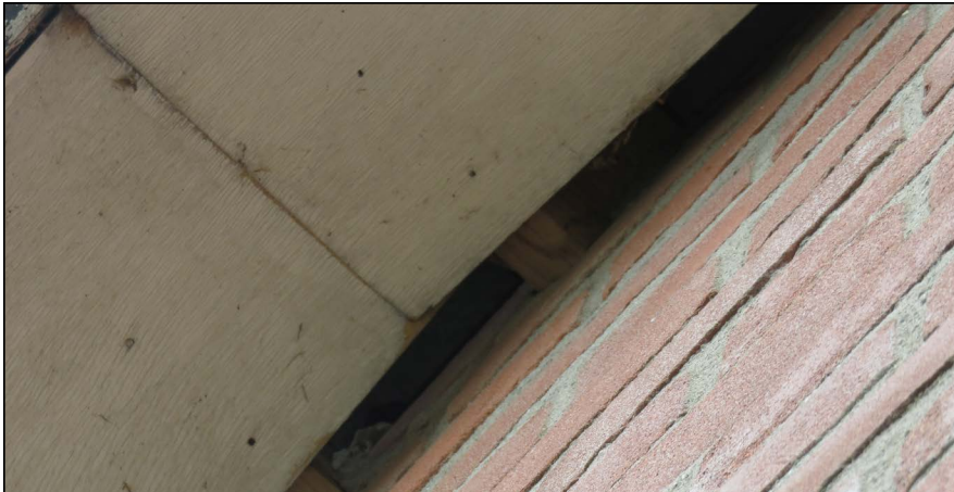
Figuur: er zijn openingen aanwezig tussen het hout van de nok en de muren van één van de voormalige zeugenstallen, waardoor vleermuizen de spouwmuur in kunnen en verblijven kunnen hebben.
