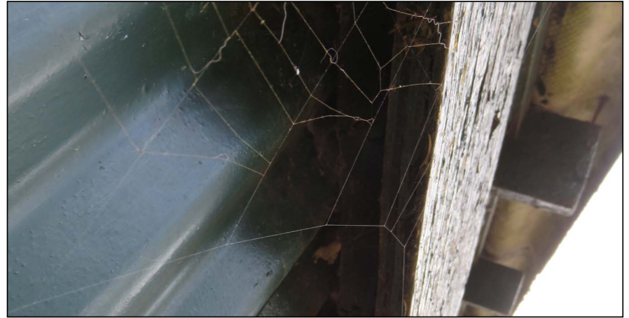
Figuur: ruimte is aanwezig achter de houten beplating van de garage/voormalige rundveestal waar vleermuizen in kunnen kruipen en verblijven kunnen hebben.
