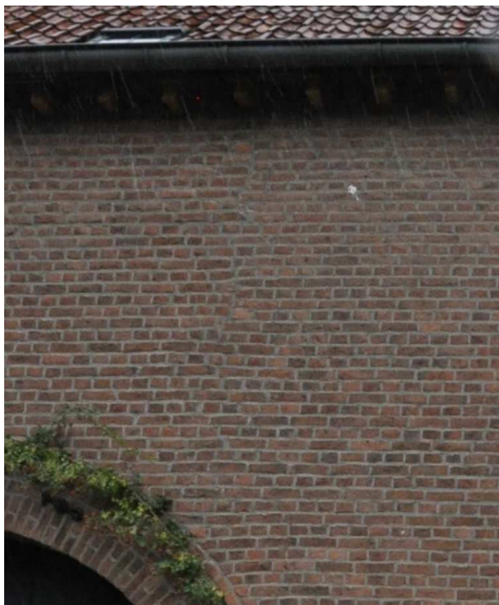
18. Detail van de bouwnaad tussen de voorgevel van het woonhuis/poort en blinde gevel van de rechterzijvleugel.
