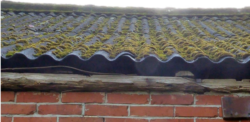
Schuur aan de woning met enkelsteens muur en dakplaten, niet geschikt voor vleermuizen.
