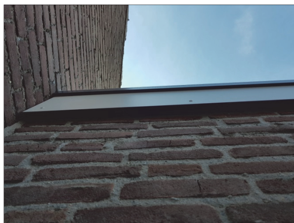
Figuur 9. Openingen achter dakrand betimmeringen
