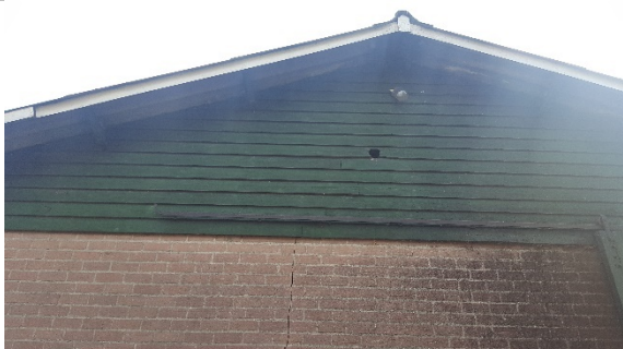
Figuur 16. Gebouw 2; gat in de houten betimmering van de noordwestgevel. Hierdoor is het gebouw toegankelijk voor huismus, uilen en vleermuizen.
