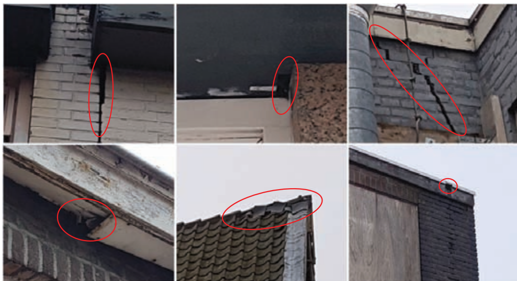
Figuur 3 Aangetroffen openingen welke mogelijk functioneren als vaste rust- en/of verblijfplaats voor gebouwbewonende vleermuizen.
