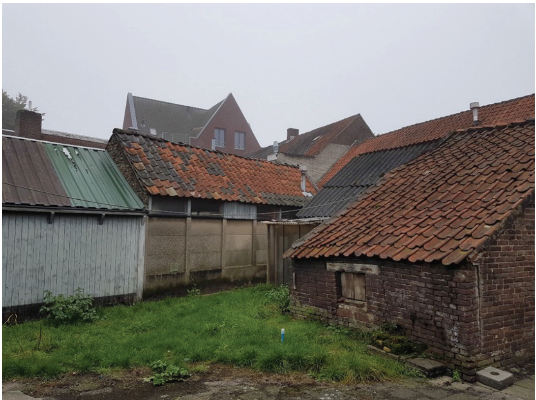
Figuur 6 Vervallen (hobby)schuren in het westelijke gedeelte van het plangebied. De meeste opstallen zijn vrij toegankelijk voor broedvogels en grondgebonden zoogdieren.
