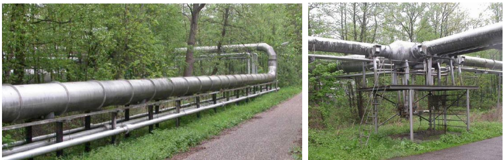
Stelsel van leidingen en buizen op het terrein
