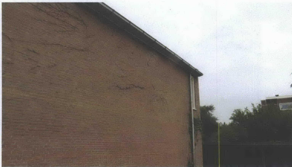
Foto 5. Afstaande betimmering (spleet ca. 1,5 cm) achter dakgoot van de gymzaal: hierachter bevond zich op 13 september 2013 een baltsende man ruige dwergvleermuis. De ruimte (spleet) achter de betimmering doet hier blijkbaar dienst als paarlocatie. Als overwinteringslocatie bij vorst is de betimmering ongeschikt.
