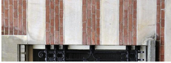
incidenteel pleister / keimwerk
