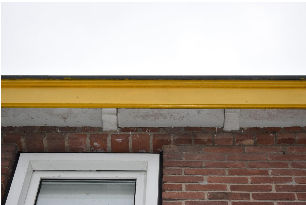
Figuur 9. Via deze ruimte kunnen vleermuizen ook de spouwmuur bereiken. Daarnaast is het ook groot genoeg om als aanvliegroute voor gierzwaluwen naar onder de dakpannen te fungeren. Hier zijn ook al uitwerpselen van vogels aanwezig.
