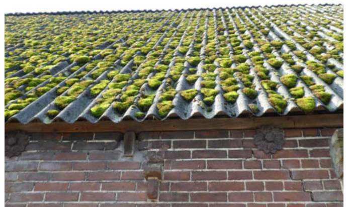
Figuur 17 Dak met asbest golfplaten
