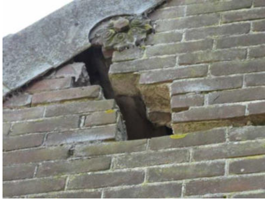
Figuur 14 Grote gaten in buitenmuur
