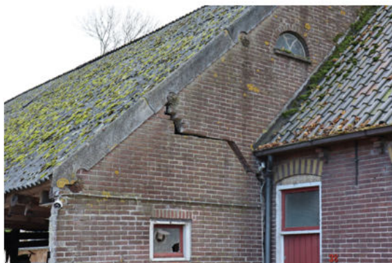
Scheuren in de schuur.
