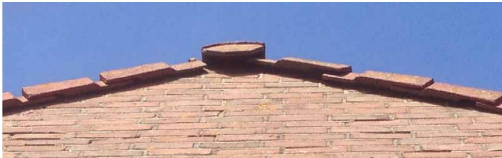
Figuur 2 De kantpannen sluiten niet naadloos aan op de gevel. Ter hoogte van de overlapping is sprake van een kier waardoor vleermuizen onder het dak kunnen kruipen en mogelijk ook in de spouw.
