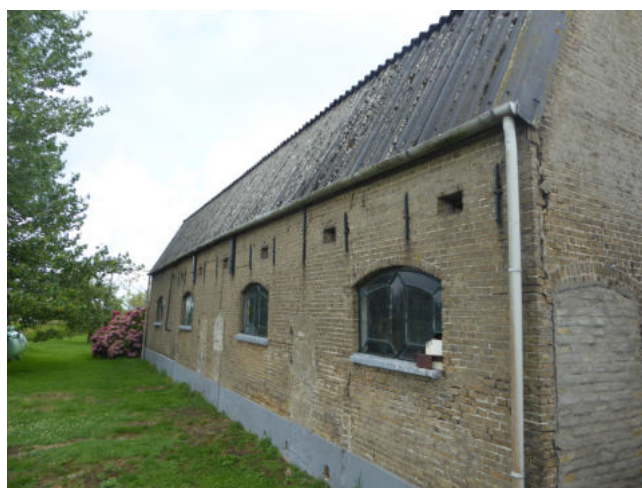
Afbeelding 3: Buitengevel van schuur 1. Scheuren in de gevel en constructie van het dak zijn zichtbaar. Foto: C.E. Bakker | Ecoresult B.V.
