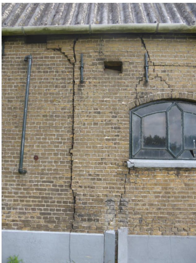
Scheuren in gevels van schuur 1. Foto: C.E. Bakker | Ecoresult B.V.
