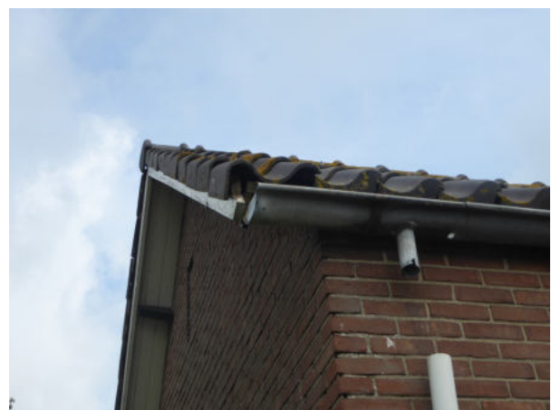
Afbeelding 7: Dakgoot, kapotte regenpijp en ruimte onder dakpannen gebouw 2. Foto: C.E. Bakker | Ecoresult B.V.
