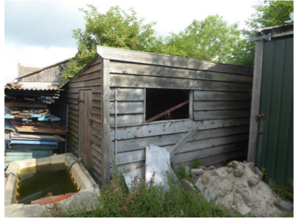
Afbeelding 17: Impressie houten schuur 9. Ingestorte gedeelte is niet te zien op de foto. Foto: C.E. Bakker | Ecoresult B.V.
